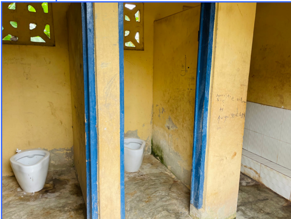
Kapotte toiletdeuren in Ghana.
